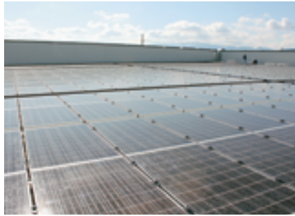
ならコープ物流センター屋上の太陽光パネル
